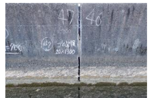
▲目地の劣化状況
