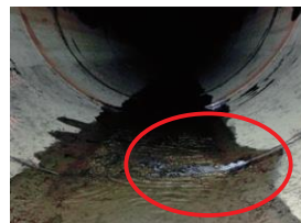
▲管内の漏水状況
