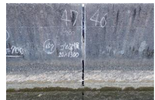
▲目地の劣化状況
