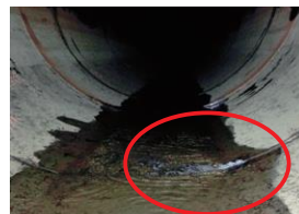
▲管内の漏水状況
