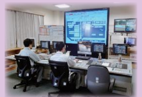
施設管理(監視、操作)の状況
