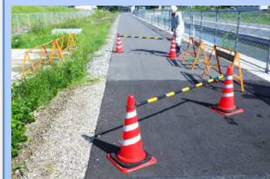
被災箇所確認及び対応状況
