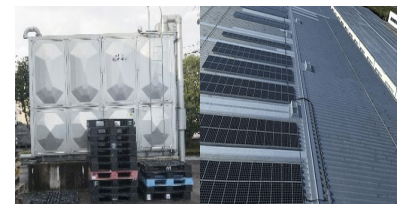
地中熱システム（左）と太陽光発電（右）を併用したクリーン工場
