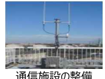
通信施設の整備
