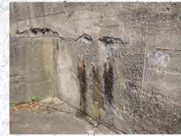
A 岩洞ダム洪水時劣化状況
