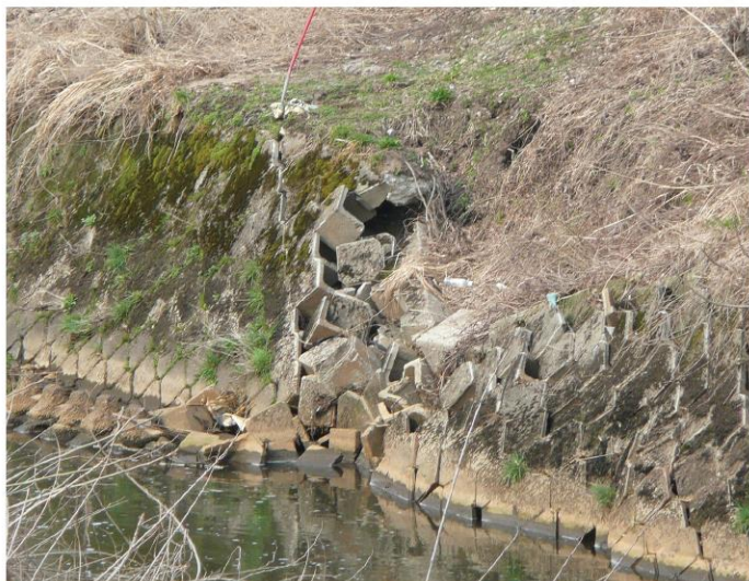
大宮川幹線排水路における積ブロックの崩壊
