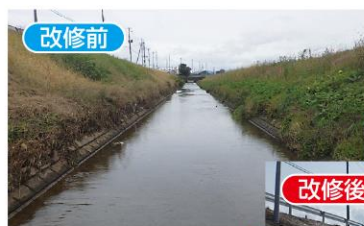
皆瀬3号幹線用水路
