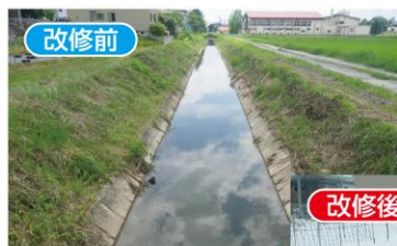
皆瀬1号幹線用水路
