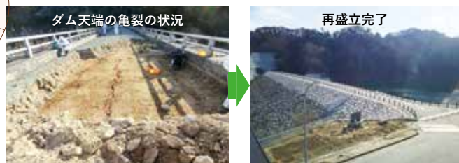
【▼大柵ダム天端の被災及び再盛立状況】
