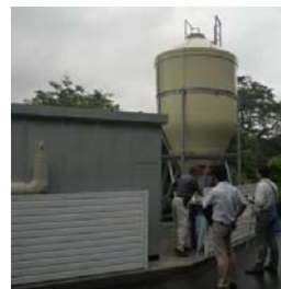
給湯用ボイラ
