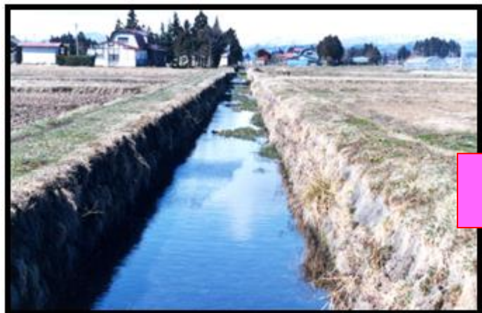
【改修前の水路の状況】
