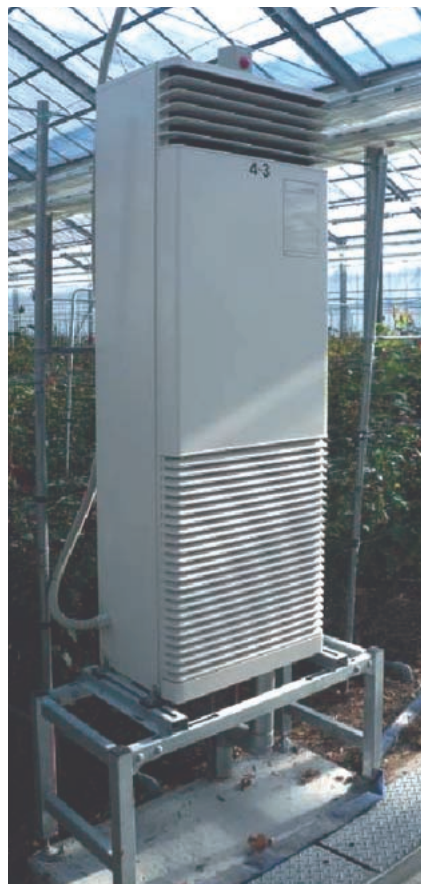
写真1 ハウス内のヒートポンプ
