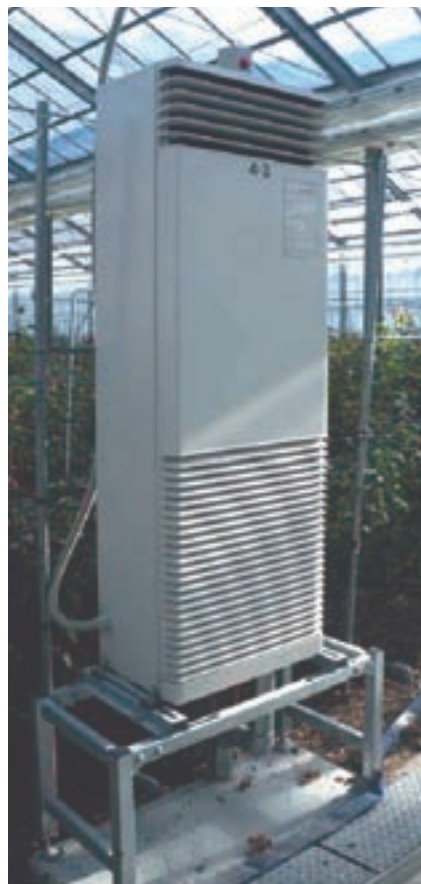
写真1 ハウス内のヒートポンプ
