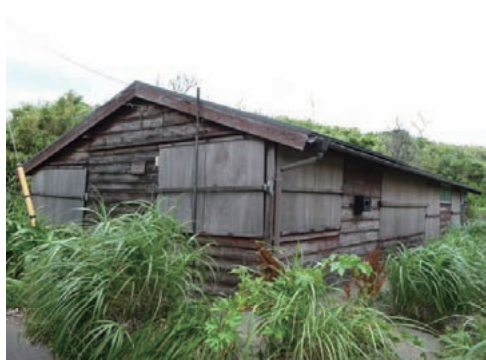
写真1 高濃度地域で廃屋となった住居
