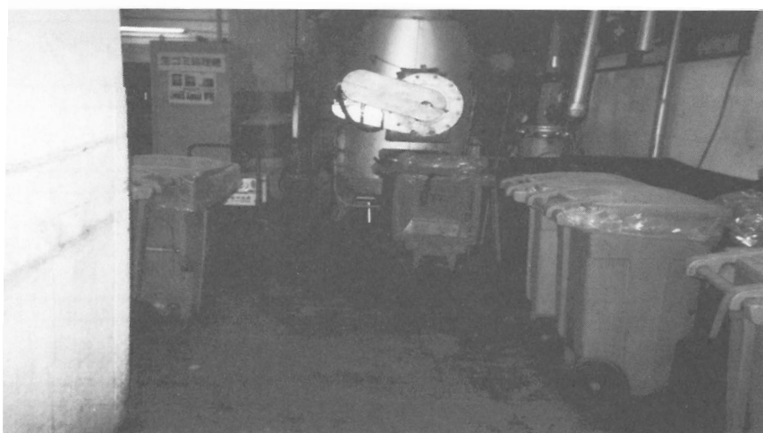
写真4 屋上（9階）にある生ごみ処理施設の内部
