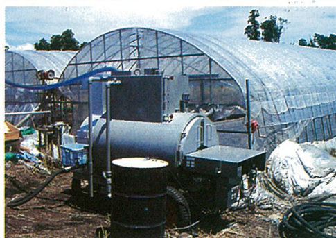
(熱水調整用ボイラー)
