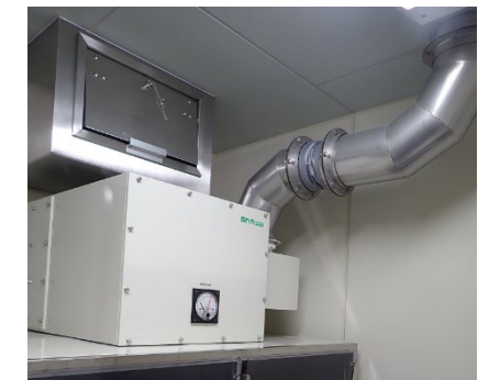
排気用HEPAフィルター
