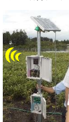
センサー・電磁弁制御装置
