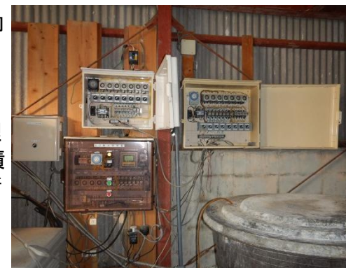
統合環境制御盤で管理
