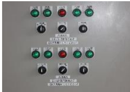
制御装置(一部)
