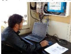
ハウス内の様々な データを確認
