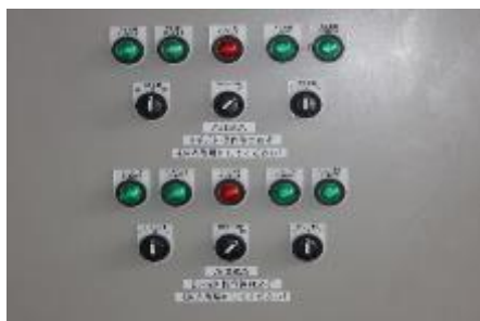
【制御装置(一部)】
