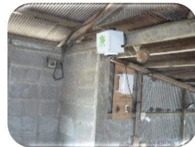
監視カメラ(移設可能タイプ)
