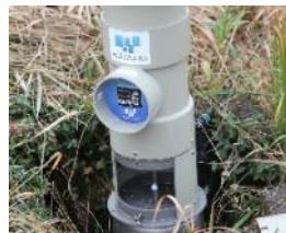
自動・遠隔操作水管理システム
