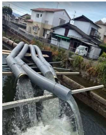
用水路への農業用水ポンプアップ
