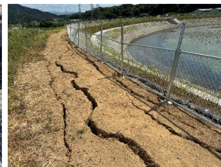
ため池堤体のクラック
