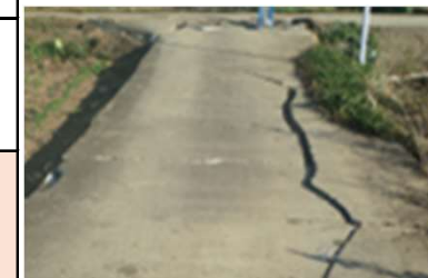
コンクリート舗装の割れ
