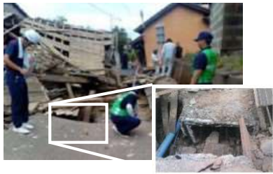
幹線水路の被災状況
