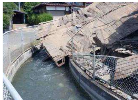
水路への建物の倒壊
