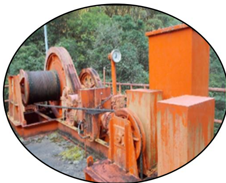
せこがわ 瀬江川頭首工 の老朽化
