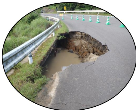
幹線水路 漏水事故
