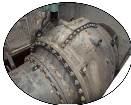
すぎやす 杉安取水工 バルブの老朽化
