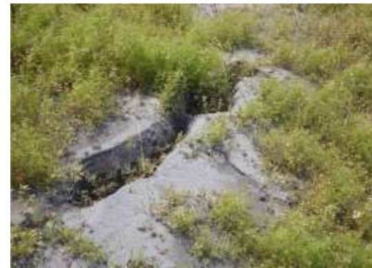
昭和海岸の堤防の被災状況
