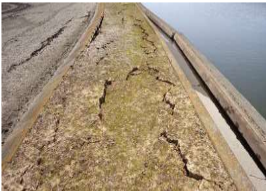
郡築海岸の堤防の被災状況
