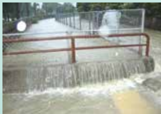
不知火幹線水路の溢水
