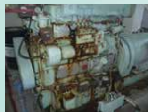
ポンプ設備の老朽化
