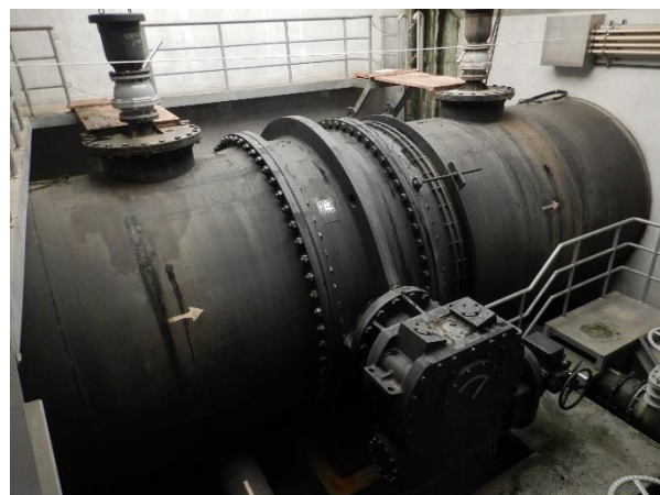
佐賀東部導水路制水工
