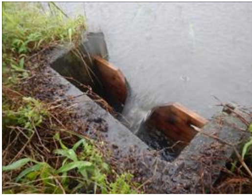
調整板設置状況（佐賀市）
