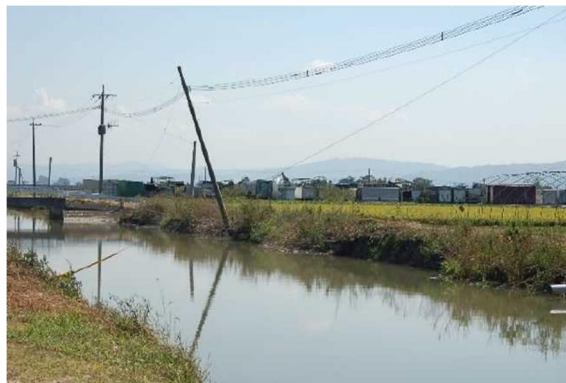
写真：電柱の傾倒
