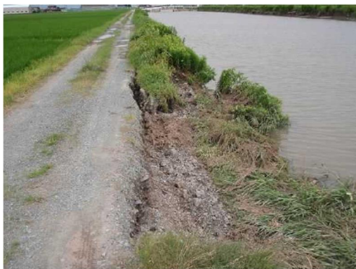
写真：道路の崩壊
