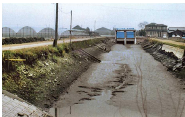
写真：崩壊した土砂による水路内の堆積、制水門等の機能低下
