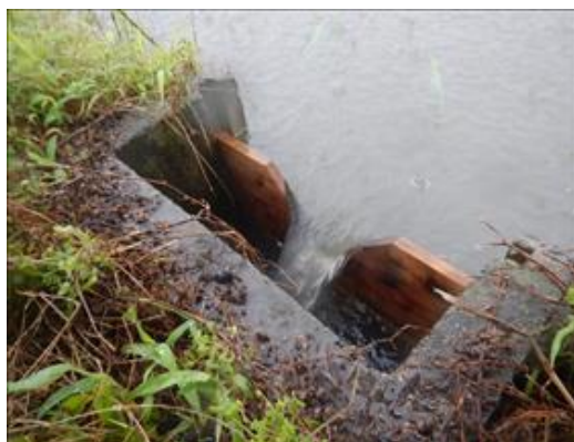
調整板設置状況（佐賀市）
