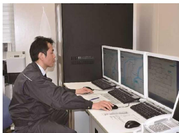
写真-6.1.3 中央監視システム
