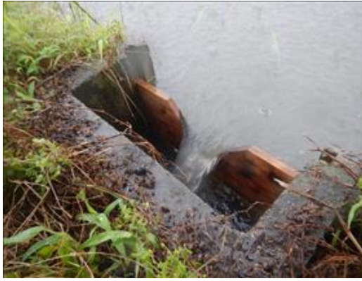
調整板設置状況（佐賀市）
