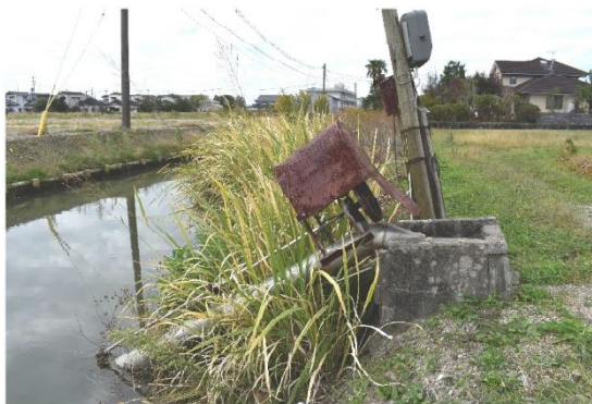
＜事業実施前＞ バーチカルポンプによるかん水
