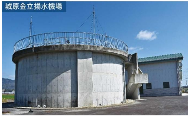
城原金立揚水機場
