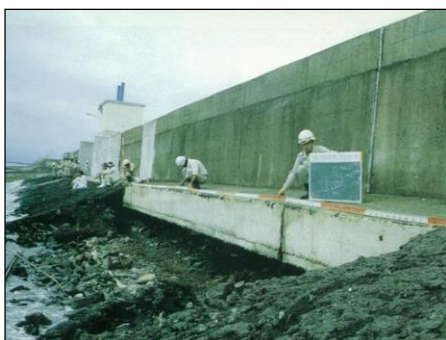
パラペット基礎部の洗堀
