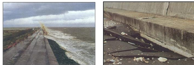
台風13号（昭和60年8月31日）による被害 (最大瞬間風速43.6メートル)
