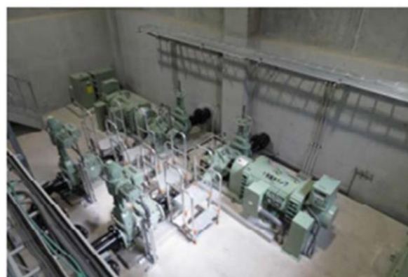
写真 5-6-6 高之峯揚水機場(室内)
