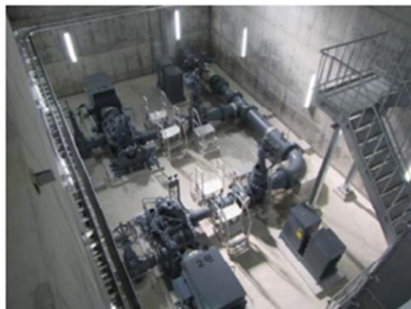
写真 5-6-2 金丸揚水機場(室内)
