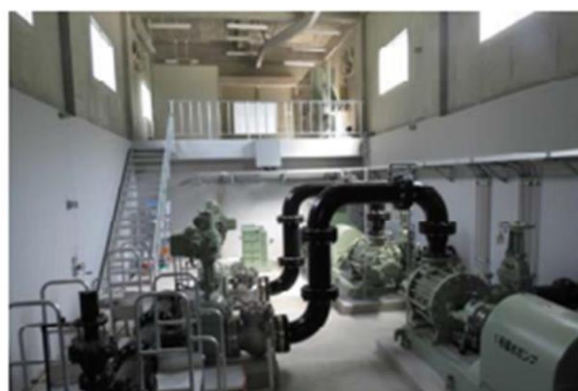
写真 5-6-8 外園揚水機場(室内)
