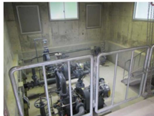
写真 5-6-4 大峯揚水機場(室内)
