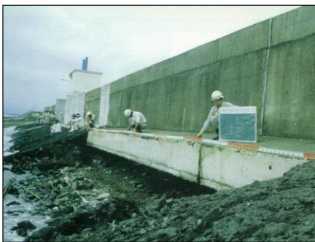
パラペット基礎部の洗堀
