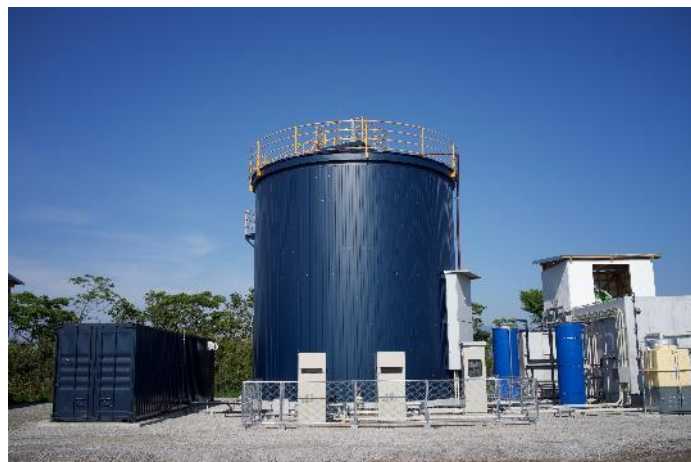
本部農場バイオガスプラント (宮崎県新富町)
