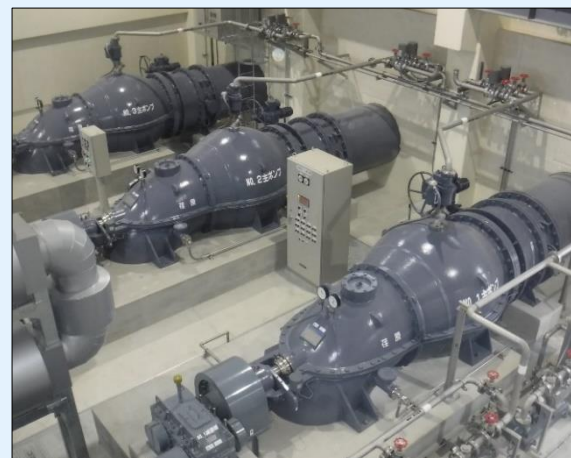
（新しい名草排水機場の排水ポンプ）
