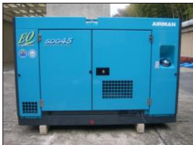
発動発電機 (45kVA)
