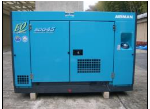
発動発電機 (45kVA)
