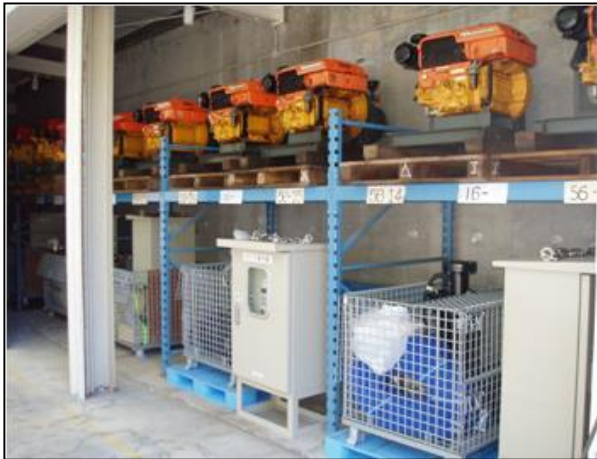
陸上ポンプ及び水中ポンプ格納状況
