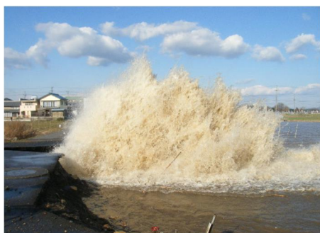
【管水路の突発事故（管の破裂）】
