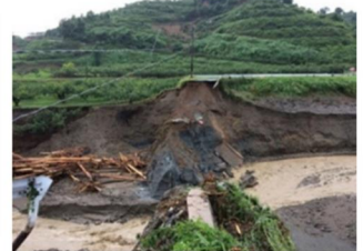
平成29年7月の豪雨により決壊（福岡県）
