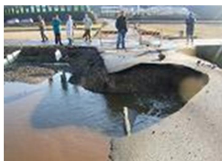
【管の破裂による道路陥没】
