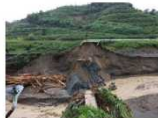
平成29年7月の豪雨により決壊（福岡県）
