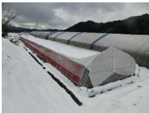
積雪による農業用ハウス損壊(兵庫県)
