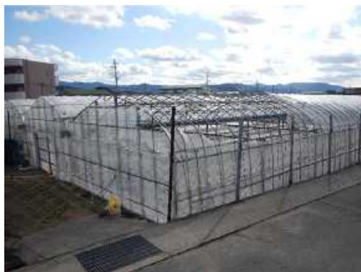
暴風による農業用ハウス損壊(和歌山県)
