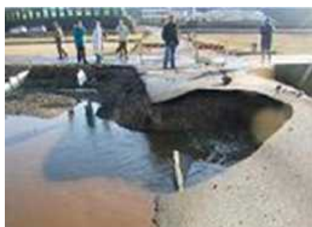
【管の破裂による道路陥没】
