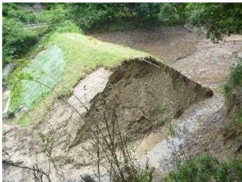
平成30年7月豪雨で決壊したため池(京都府塩津古池)
