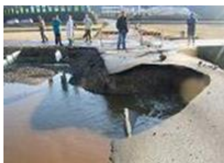
【管の破裂による道路陥没】
