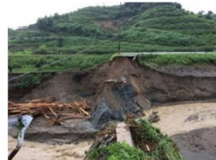
平成29年7月の豪雨により決壊（福岡県）
