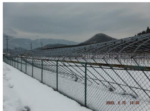
積雪によるビニールハウス倒壊(滋賀県)
