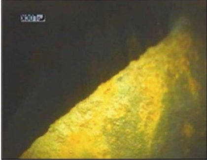
羽根車の腐食（船玉機場）
