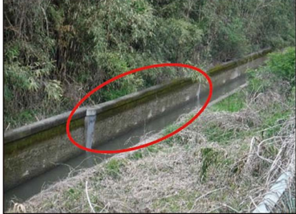
底板が割れて水路が傾いている
