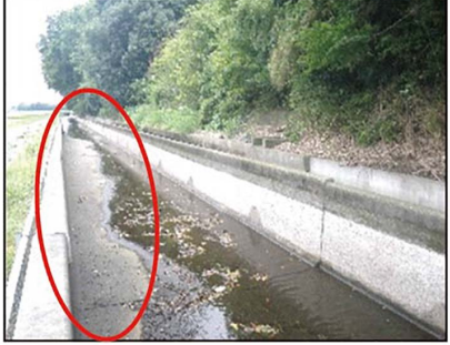
水路の片側が浮上し傾いている
