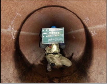
送水路の継手部からの漏水かし（川岸機場）
