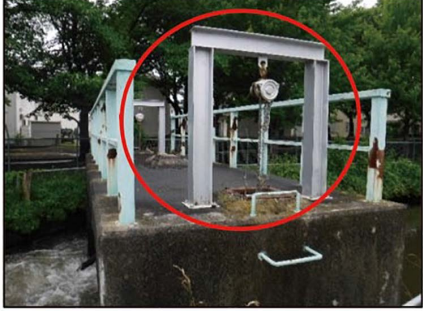
ゲート操作部が損傷している
