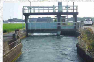
左右岸分水工ゲート
