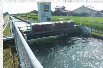
導水幹線水路(ゲート設備)
