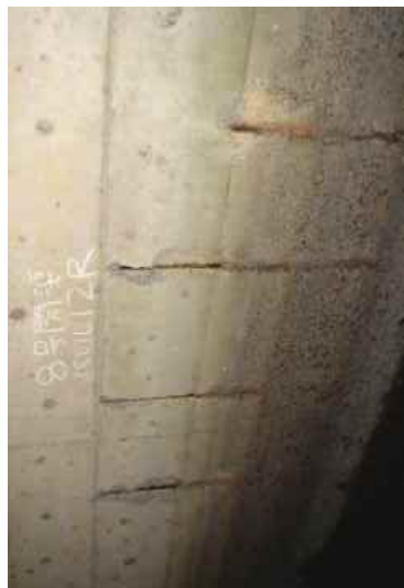
側壁部の鉄筋が露出している。
