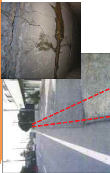
水路頂部の亀裂やひび割れが発生している。
