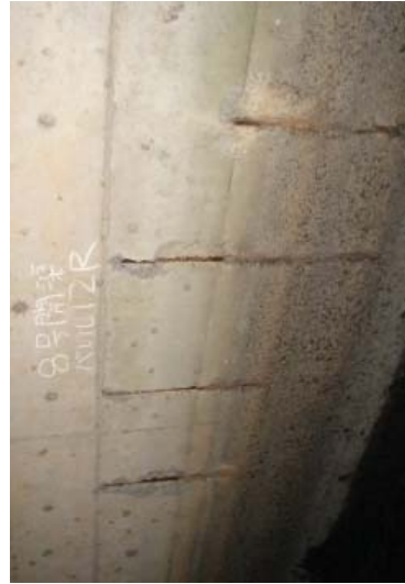
側壁部の鉄筋が露出している。
