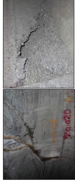
ひびわれや剥離の発生
