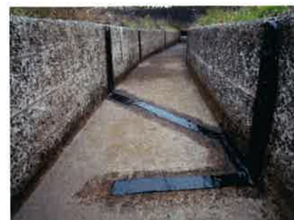
現場打ち水路 ひび割れ
