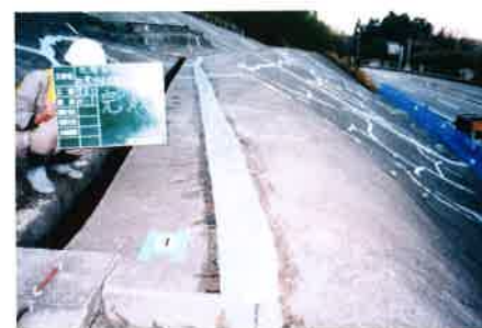
法面ひび割れ
