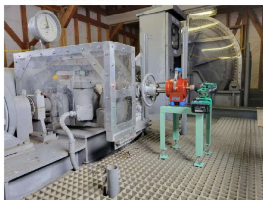
各水門に設置 計3基納入
