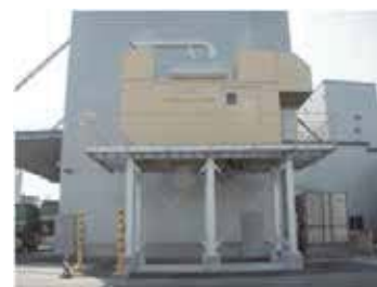
非常用自家発電機
