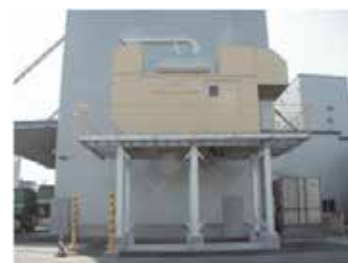
非常用自家発電機
