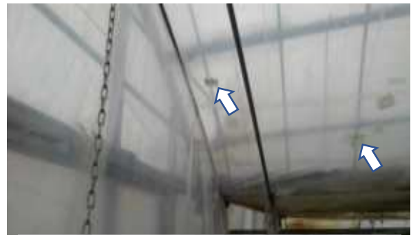
（ビニールハウス穴開き箇所）
