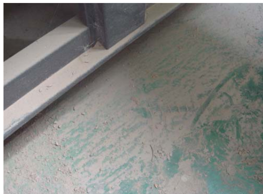
建物の床にたまったほこり
